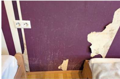
Ko je lastnik po izselitvi najemnikov prvič stopil v stanovanje, ni mogel verjeti svojim očem: "Stanovanje so uničili!" Foto: Osebni Arhiv
